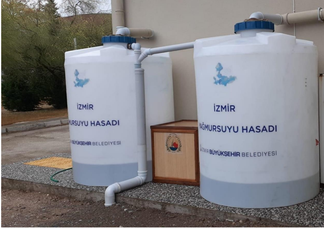
Şekil 3.9: İzmir Sünger Kent Projesi yağmur suyu depoları. [10].
